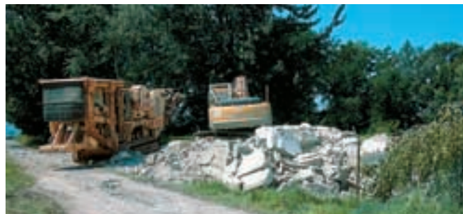
Heute: Jede Menge Bauschutt - das ist alles was von dem letzten Haus auf dem ehemaligen Livana Gelände in Zech übriggeblieben ist
