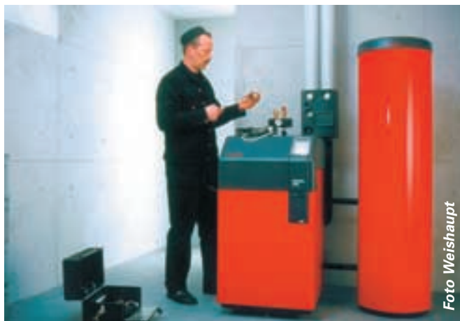
Neue Generation von Heizungen benötigen einen Wartungsvertrag
