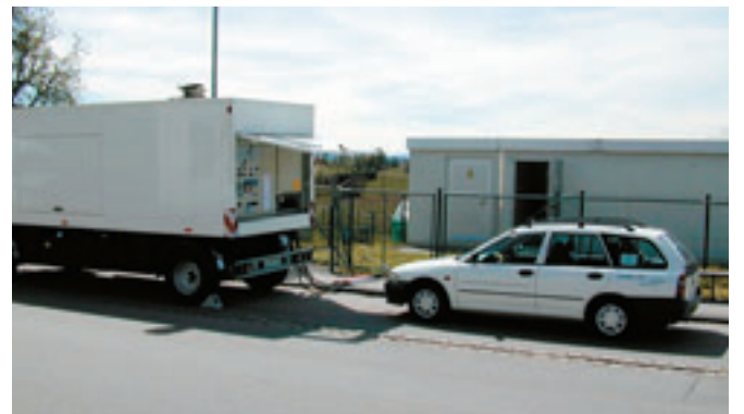
Einsatz des 500kVA-Aggregats vor der 10.000V-Station Schönau
