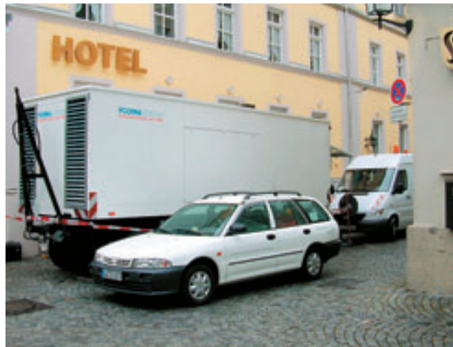
Das 500kVA-Aggregat im Einsatz auf der Insel
