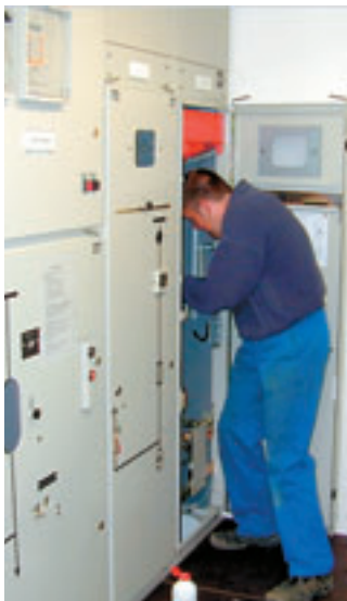
Prüfung in der 10.000V-Anlage
