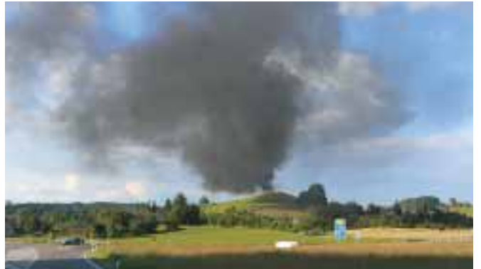
Am 9. Juni sah's in Wildberg aus, als ob ein Vulkan ausbrechen würde. In kürzester Zeit war die Weißensberger Feuerwehr zur Stelle um einen gefährlichen Brand von Bitumen und Schaumglas inmitten von Gasflaschen auf der Baustelle des neuen Wasserhochbehälters zu löschen. Der Wind stand Gott sei Dank günstig, verletzt wurde niemand. Der Sachschaden ist allerdings erheblich, die Bauarbeiten verzögern sich. Fotos: Stefan Seufert
