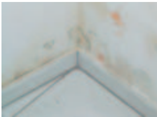
Schimmelpilze in Wohnräumen sollte auf keinen Fall akzeptiert werden. Das gesundheitliche Risiko ist als gravierend einzustufen.
